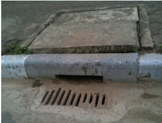
Hình 3. Thu nước trực tiếp từ mặt đường
